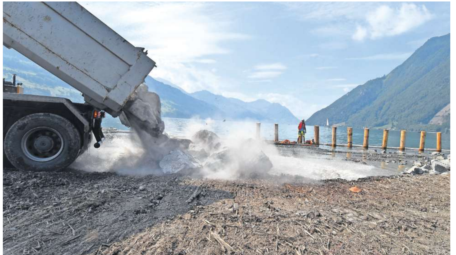
Für die Renaturierungen im Gebiet Hopfräben wurden gestern Blocksteine abgeladen. Bild: Andreas Seeholzer
